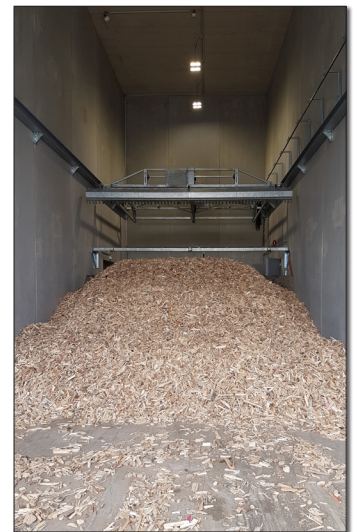
Silo de stockage
