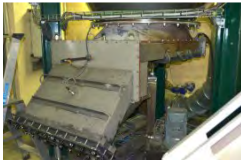
Système de décendrage du gazéifieur, photo FD
