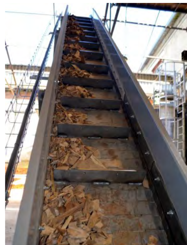
Système d'extraction du silo à bois déchiqueté de Guyenne Papier, photo FD
