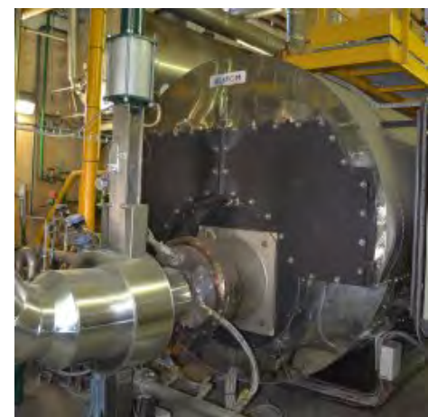
Le brûleur Gasclean est installé sur une chaudière à gaz de 3,5 MW et 8 bar, photo FD
