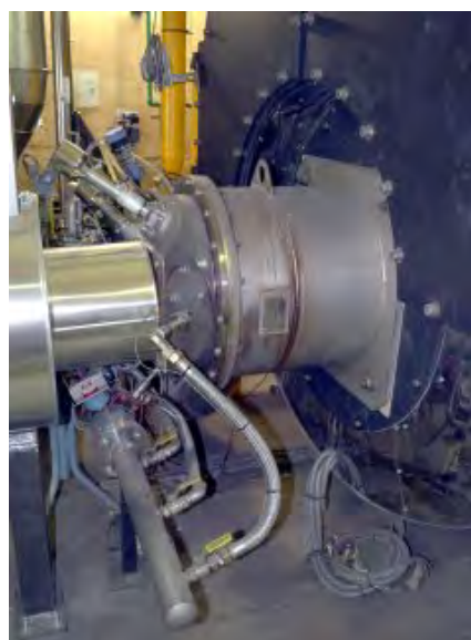
Le brûleur Gasclean de 1,5 MW, photo FD
